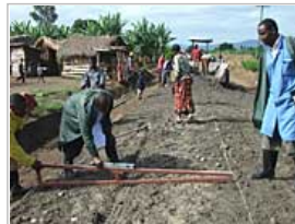
実習にて工事が設計通りに行われているか確認する研修員
